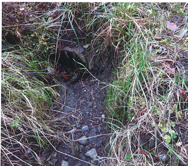
Figur 3 Foto på dagvattentrümna som leder vatten under järnvägsbanken.
