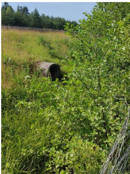
Figur 7 Trumma DN800BTG under riksväg 40
